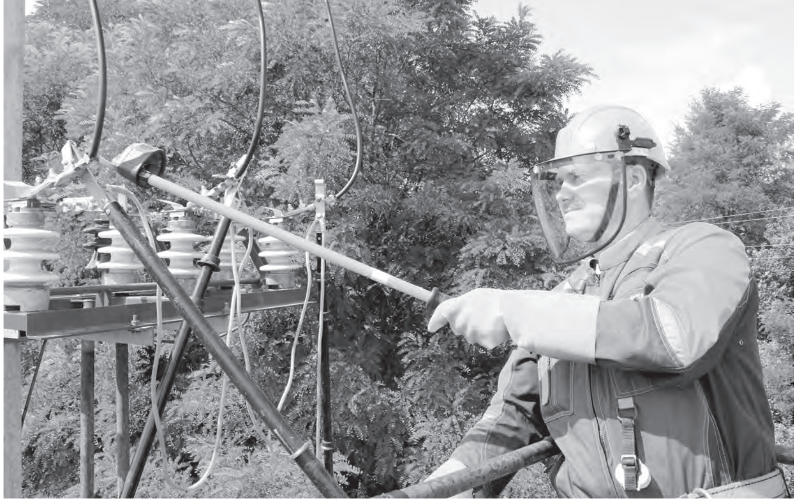
Электромонтер Дмитрий Вырвич приехал из Брестской области, чтобы помочь коллегам восстановить упавшие опоры линий электропередачи и обрывы проводов воздушных линий в пострадавших населенных пунктах Мозырского района.
